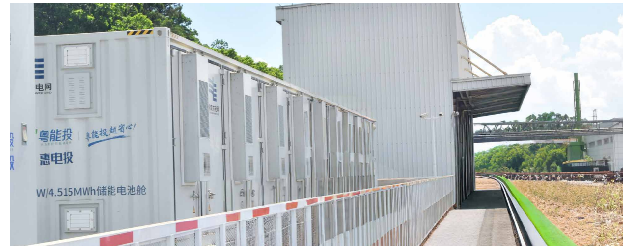
▲ 旗下东风本田汽车零部件有限公司光伏储能建设
